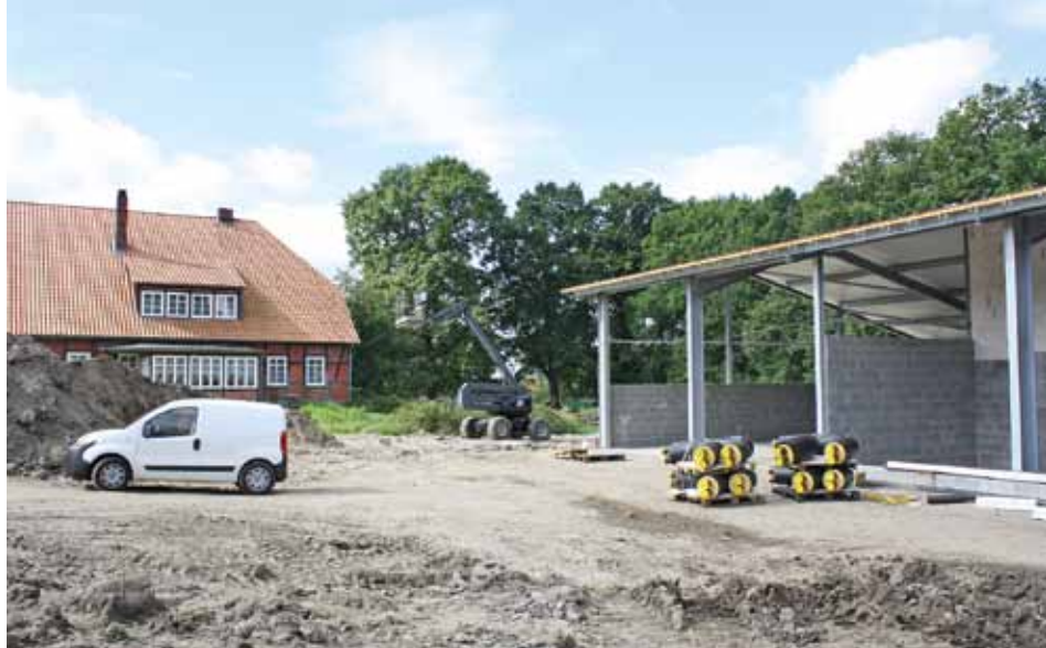
In einer neu errichteten Halle können 800 Schüttraummeter gelagert werden, so dass im Extremfall bei hohen Minustemperaturen auch zwei Wochen lang die Wärmeversorgung garantiert werden kann. Es wurden entsprechende Verträge ausgehandelt, in denen sich die Lieferanten dazu verpflichtet haben, innerhalb kurzer Zeit zu liefern.
